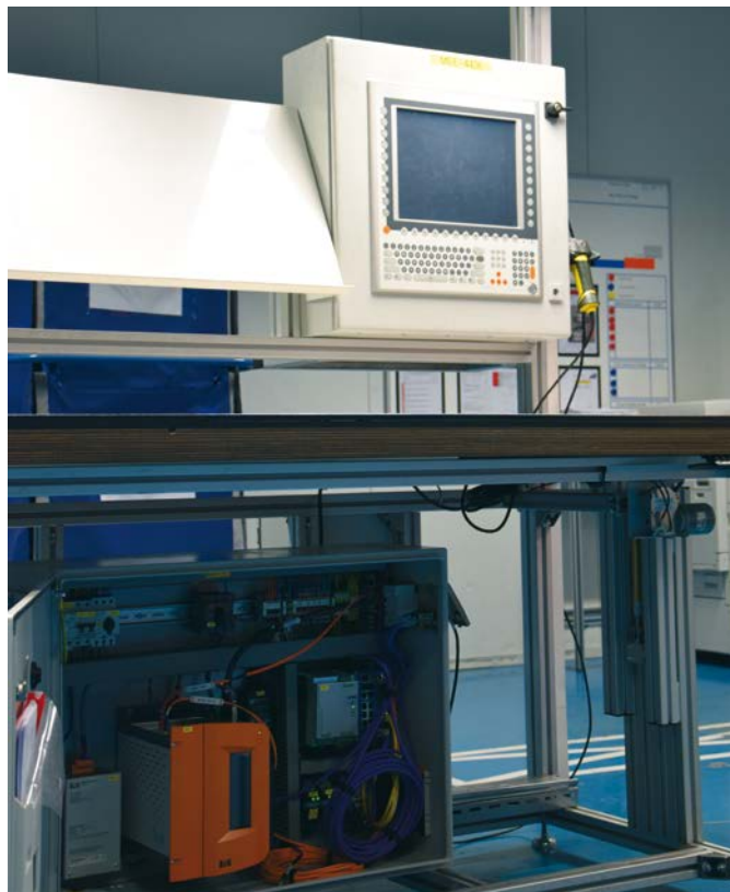
Die Automation PCs von B&R sind auf 95% aller Linien installiert, teilweise in Kombination mit Single-Touch- oder Multi-Touch-Automation Panels.
