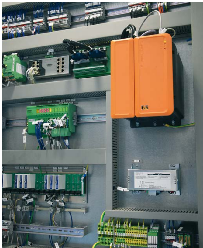
Auf der operativen Ebene laufen auf den Automation PCs SCADA-Systeme und die SQL-Datenbank, auf der Maschinenebene werden Funktionstests durchgeführt.
